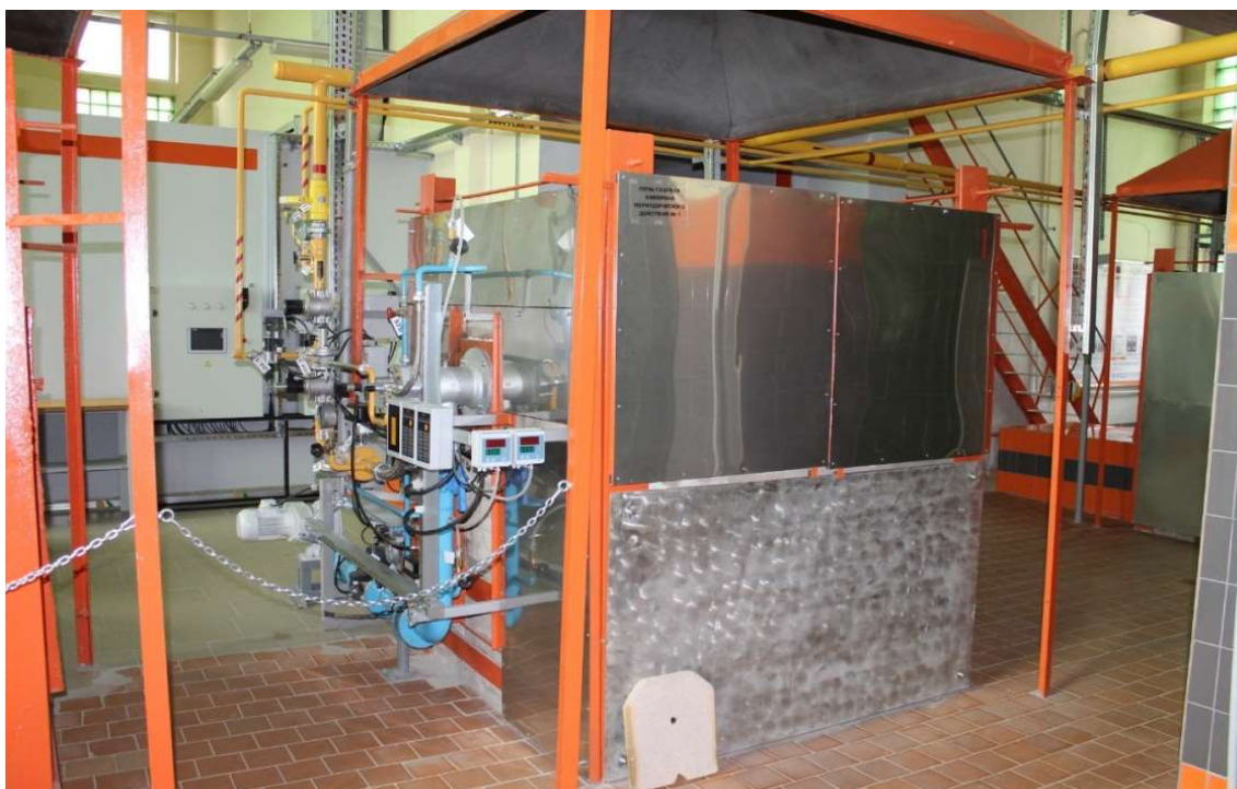
Газовая печи для варки стекол и обжига керамических материалов в лаборатории высокотемпературного синтеза кафедры технологии стекла и керамики
