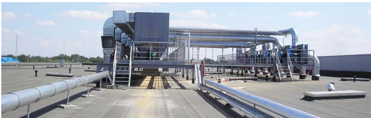
Размещение вентиляторов и фильтров САП на кровле цеха (г. Могилев)
