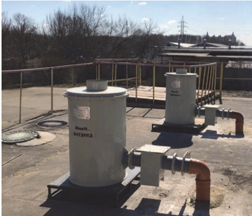
Рисунок 5 – Очистка выбросов от резервуаров КНС по перекачке илового осадка (АО «Мосводоканал»)
