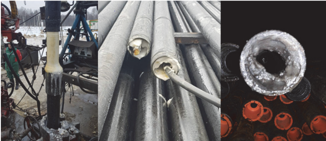
Рисунок 1 – Хлоридная соль на подземном оборудовании
