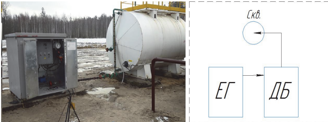
Рисунок 3 – Дозаторный блок (ДБ) с греющей емкостью (ЕГ) для подачи пресной воды на рассоление подземного оборудования
