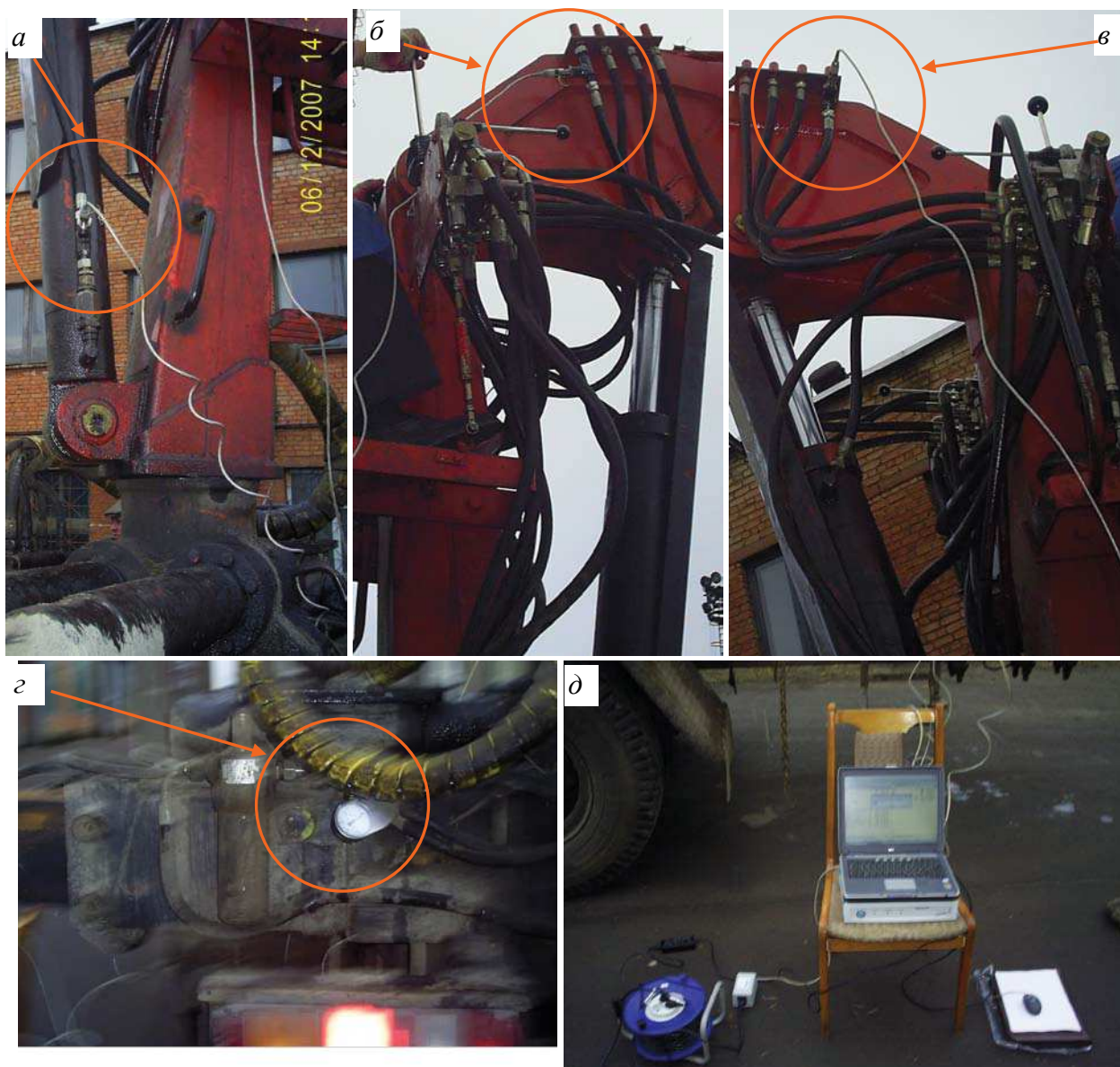
Рис. 3. Подключение измерительной аппаратуры: а, б, в – датчики давления, установленные в соответствующие напорные магистрали; г – установка манометра в трубопровод гидросистемы механизма поворота колонны; д – измерительный комплекс
