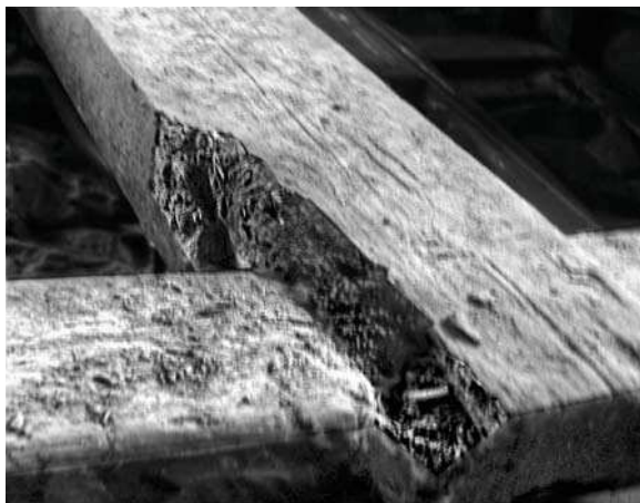
Рис. 5. Поражение балки перекрытия дереворазрушающими грибами
