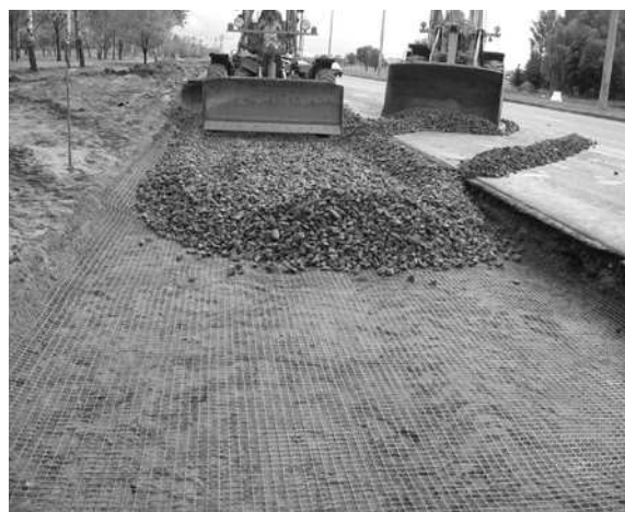
Рис. 3. Процесс устройства щебеночного основания, армированного геосеткой «Славрос СД-40», на уширении просп. Победителей в г. Минске
