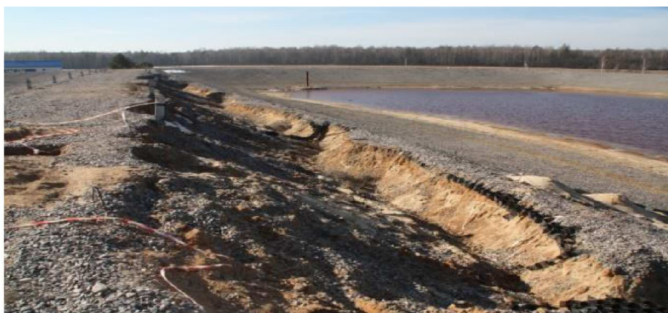
Рис. 1. Деформации верхних откосов ограждающей дамбы
