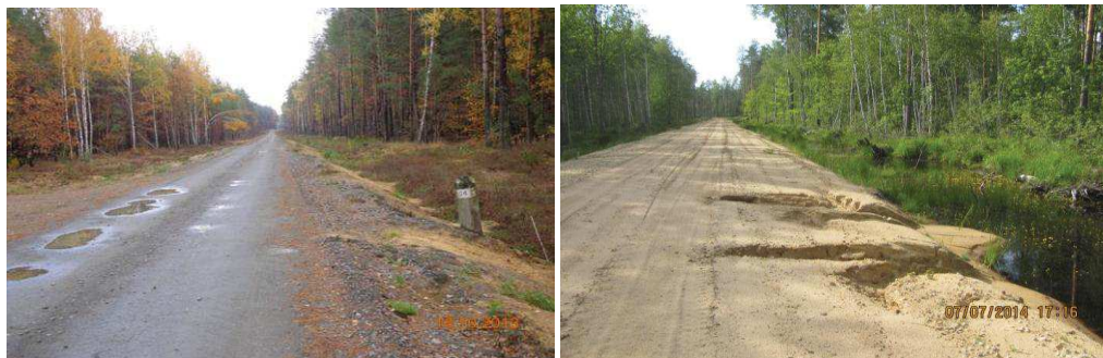
Рисунок 1 – Источники увлажнения и виды разрушения дорожной конструкции:
