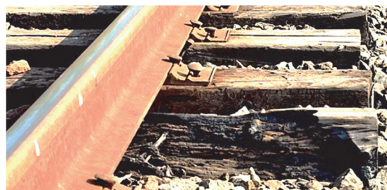
Рис. 2. Разрушение древесины вследствие нарушения технологии прикрепления костылей
