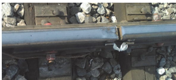
Рис. 3. Смятие конца рельса на деревянных шпалах
