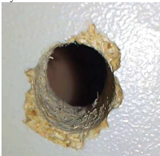
Рисунок 1 – Дефекты обработки в виде сколов на входе сверла в материал
