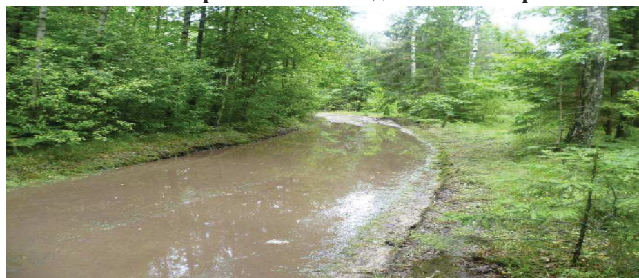
Рис. 2- Сплошное разрушение дорожного настила
