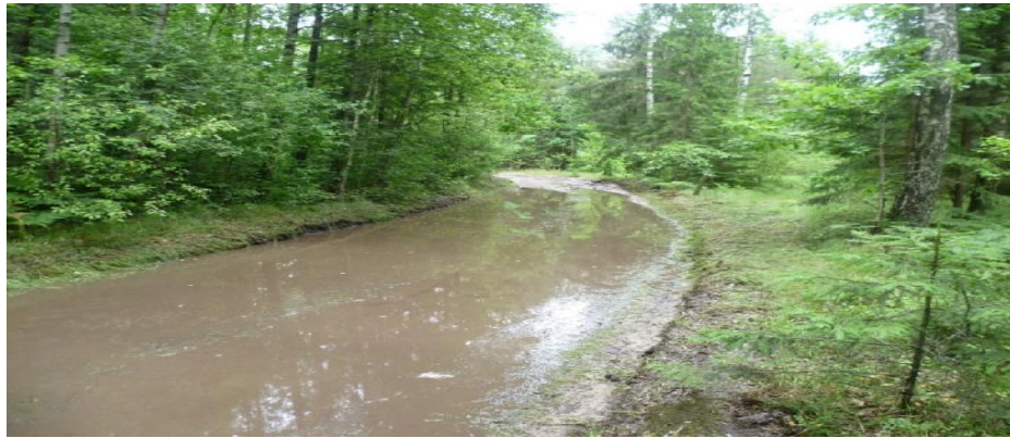
Рис. 2- Сплошное разрушение дорожного настила
