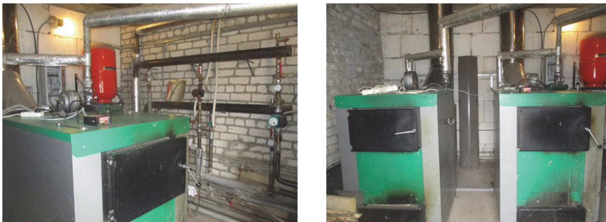
Рис. 13. Газогенераторы, подготовленные к испытаниям для сжигания твердых целлюлозосодержащих отходов, отходов производства и потребления с экологически вредными включениями
