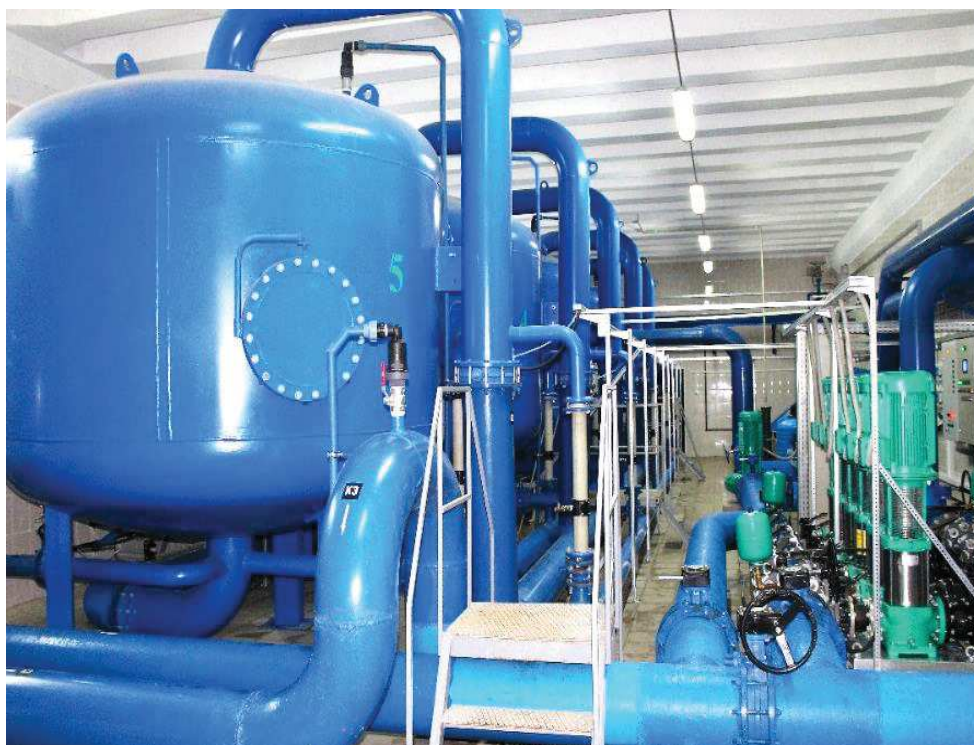
Рис. 3. Напорные фильтры обезжелезивания
