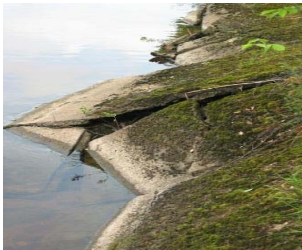
Рис. 4. Разрушение плит крепления верхового откоса на водохранилище Лепельское
