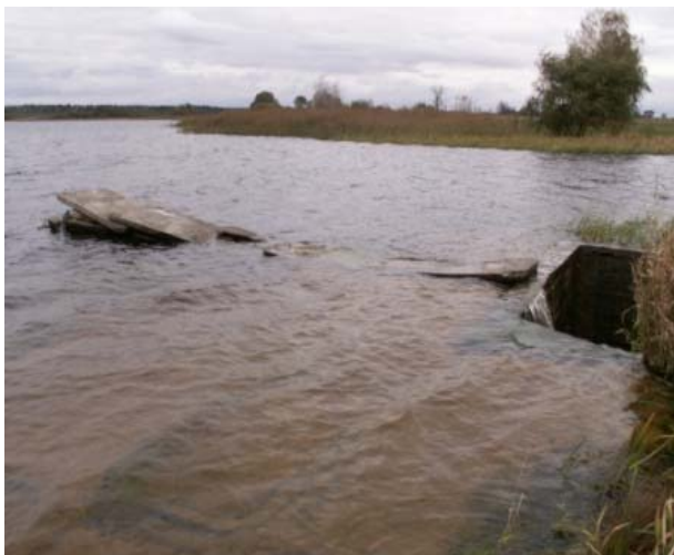
Рис. 2. Повреждения водосброса на водохранилище Лаздуны
