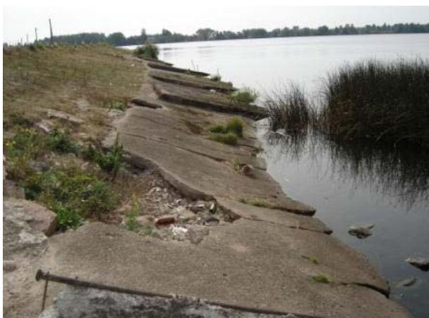
Рис. 3. Повреждения откоса плотины на водохранилище Чигиринское
