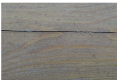
Рис. 7. Грибные повреждения на древесине лиственницы
