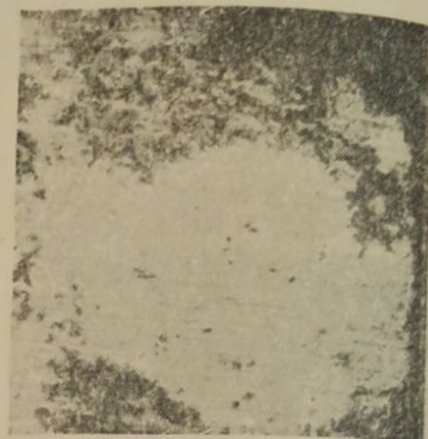
Рис. 13. Образование коррозионных очагов вблизи линейной границы металл (Fe) — бетон — 0.1 н. H_2SO_4 . Продолжительность опыта полтора месяца.
