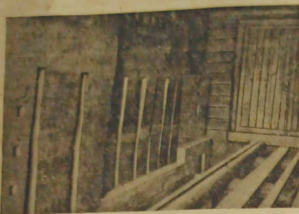
Рис. 5. Общий вид калорифера и сушильной камеры сушилки ЦНИИМЭ для газогенераторного топлива
