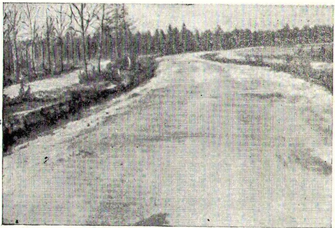
Рис. 2. Участок автомобильной лесовозной дороги Воничи — Тереболь после 3 лет эксплуатации
