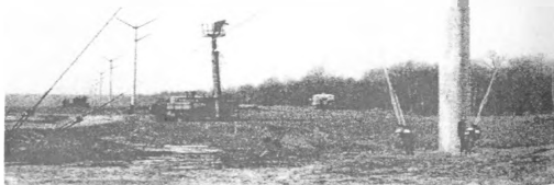
Рис. 4. Участок линии электропередачи напряжением 110 кВ с электроизолирующими траверсами
