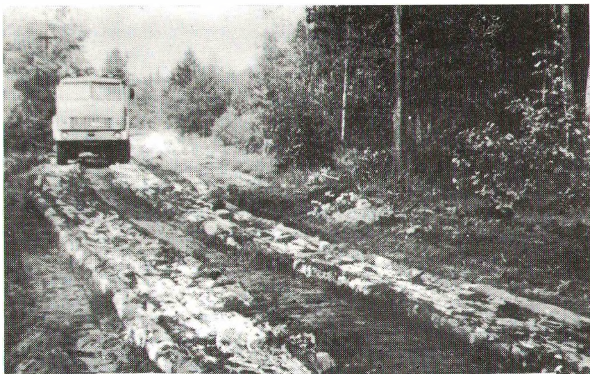
Рис. 2. Общий вид зременной лесовозной дороги из ленточного покрытия
