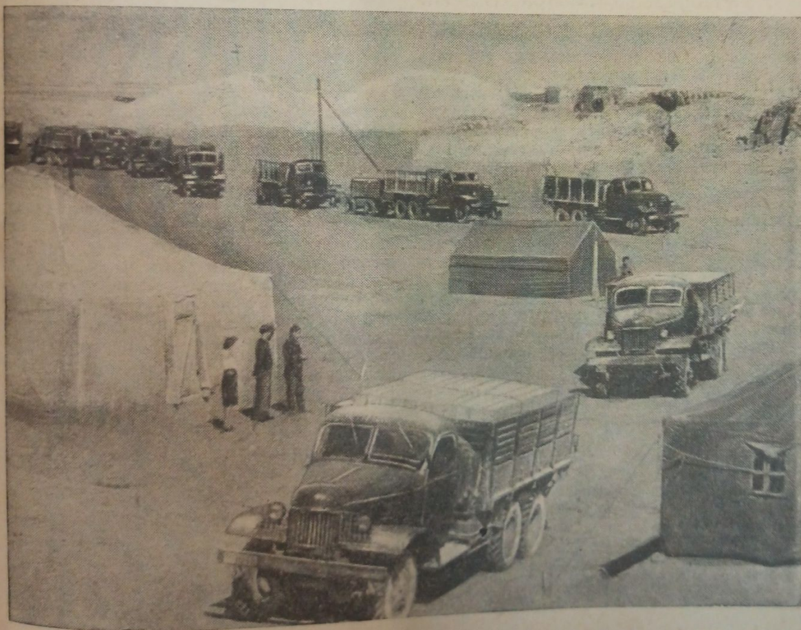
Кара-Калпакская АССР. Ежедневно на площадку строительства Тахиа-Ташского гидроузла приходят из Ургенча автоколонны со строительными материалами и оборудованием.
