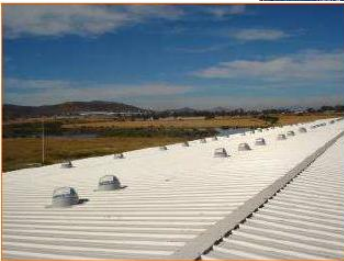
Фото 2. Светособирающие купола на крыше здания
