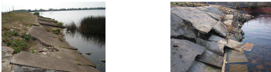
Рисунок 2 – Повреждение ж/б монолитного крепления откосов
