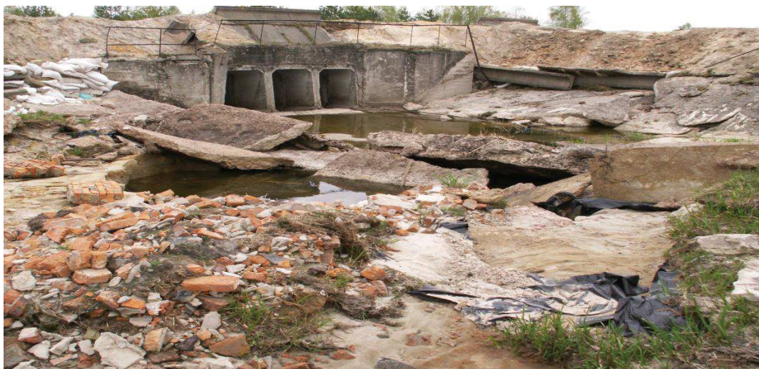
Рисунок 1 – Авария на гидроузле Млынокского водохранилища Гомельской области
